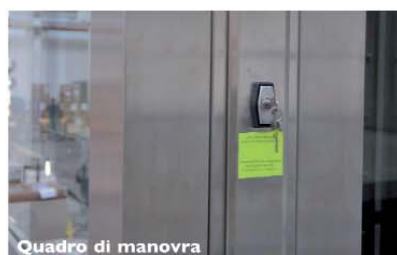
Quadro di manovra
